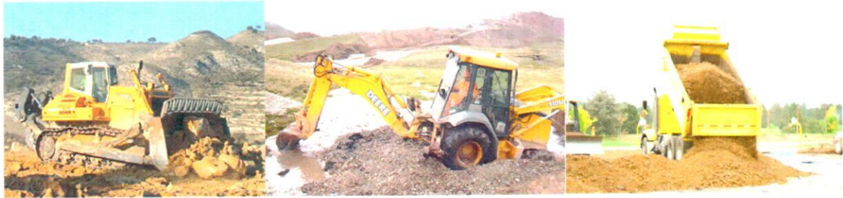
Cuadro 5: ejemplo de cómo podría quedar el cierre de la zona de Pamuch, luego de una operación ordenada y sistemática en el vertedero.
